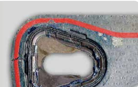
▲ Reißen bzw. Ausbrechen des Weichstoffmaterials und beschädigtes Viton-Element durch unsachgemäßes Auftragen von zusätzlichen Dichtmassen.
